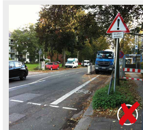
Bild 14 | Arbeitsstelle auf Radfahrstreifen ohne Absicherung
