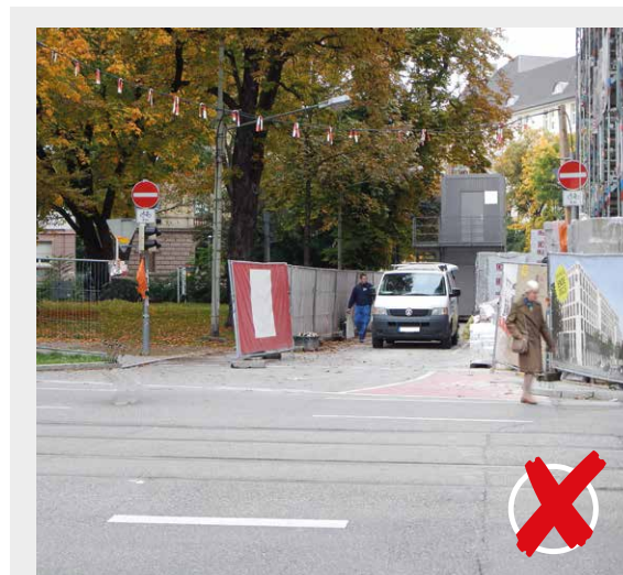
Bild 16 | Nicht geltende Verkehrszeichen sind nicht abgedeckt
