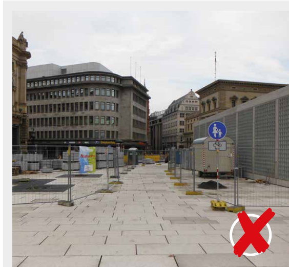
Bild 3 | schlecht sichtbare Absperrung
