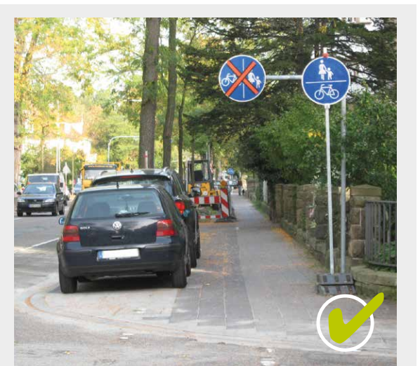
Bild 17 | Klare Kennzeichnung vorübergehend außer Kraft gesetzter Verkehrszeichen
