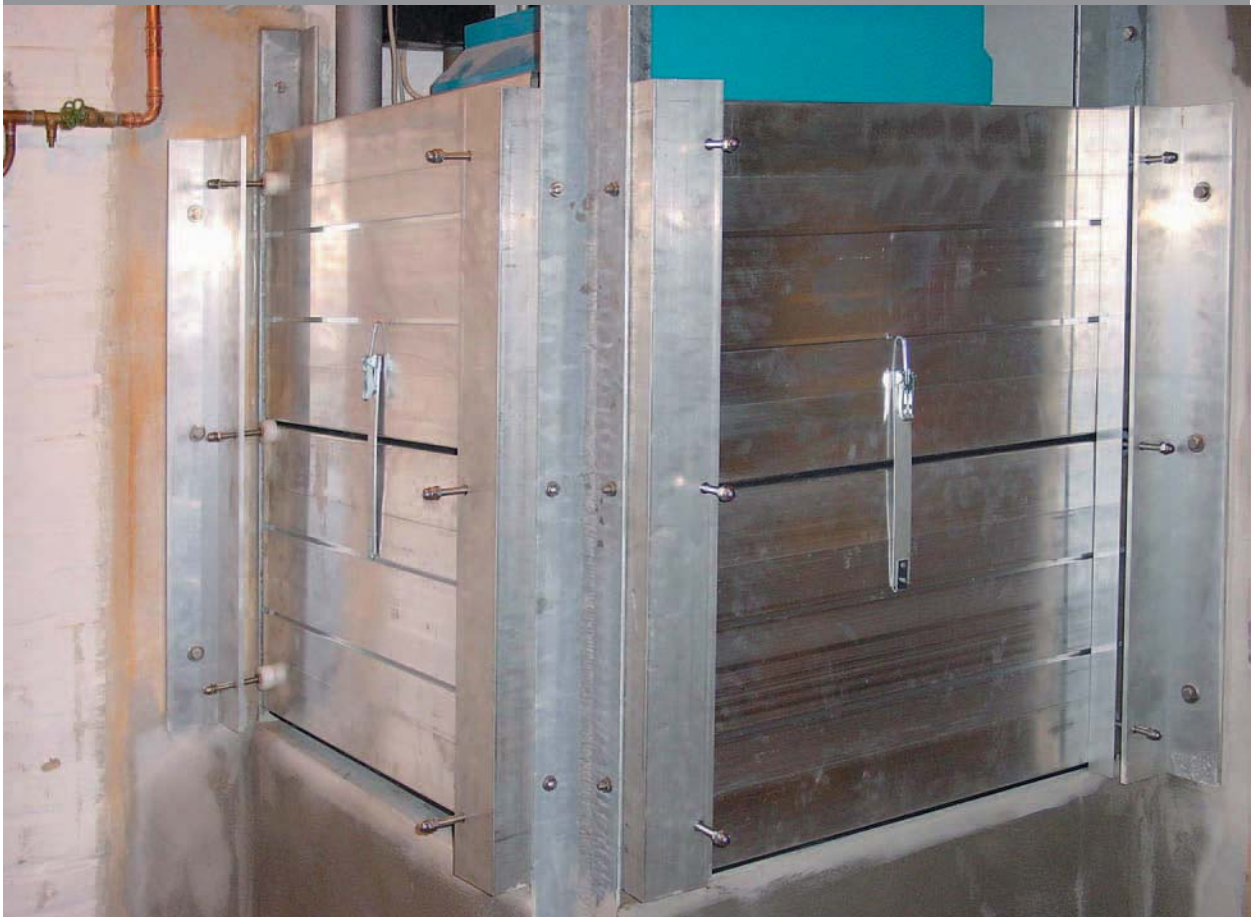
Sicherung eines Heizungs Brenners
