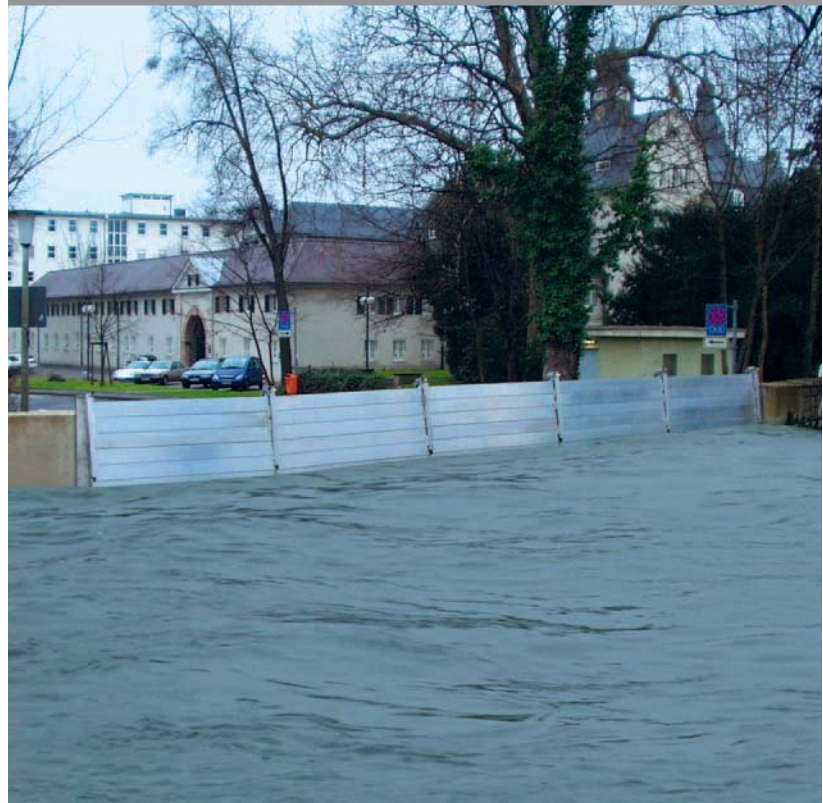
Mobiler Hochwasserschutz mit Dammbalken
